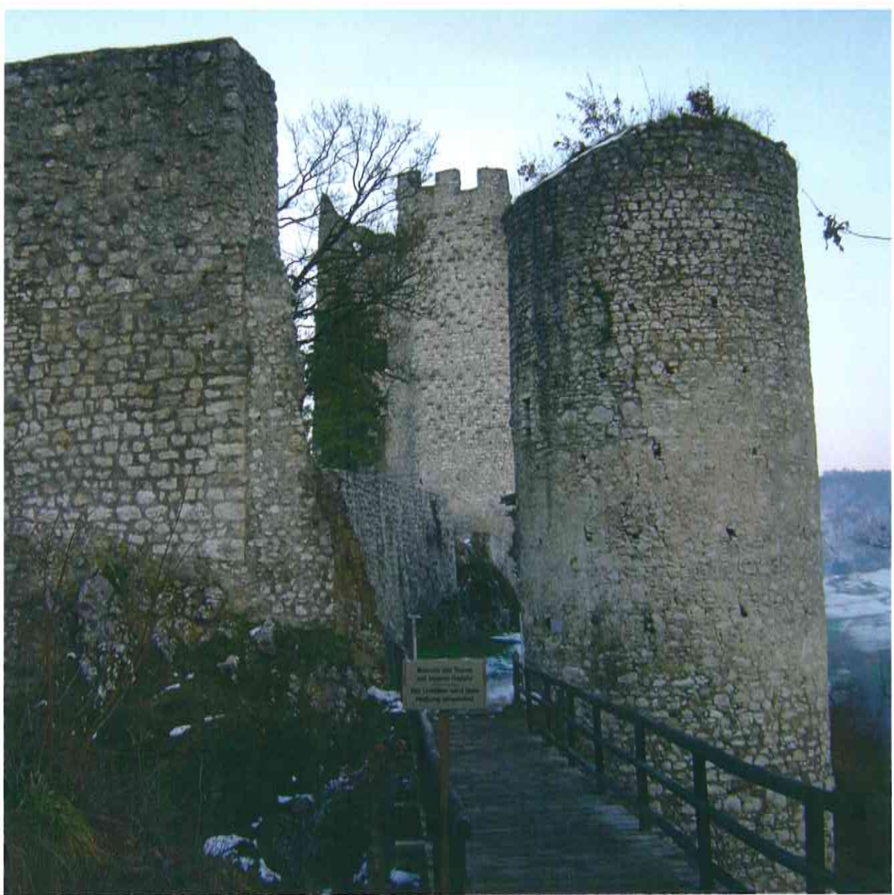
Die Ruine Pfeffingen wird seit Jahren saniert und vor dem weiteren Zerfall geschützt. The ruins of Pfeffingen Castle are being renovated, to stop it from falling further into a state of disrepair.
